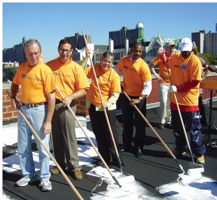
Мэр Майкл Р. Блумберг (слева), представитель НУСНА Маргарита Лопес (в центре) и председатель НУСНА Джон Б. Реа (ближний справа) за работой по переоборудованию кровли в жилом комплексе Betances Houses
