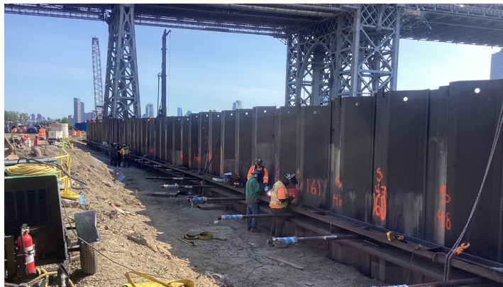
2023年8月, 滨海大道和Williamsburg大桥附近的地下防洪墙
