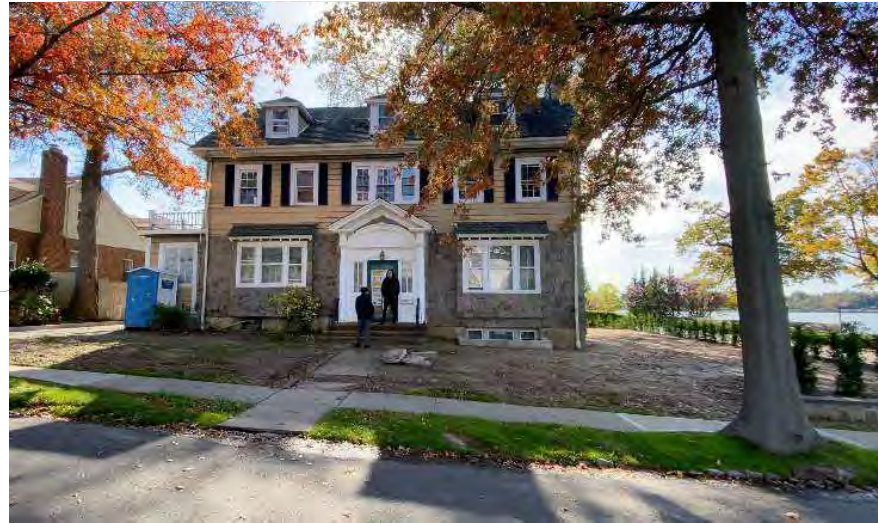
2 EXISTING SIDING CONDITION SCALE: N.T.S.
