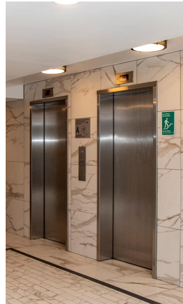
Ascensores modernizados, Independence
