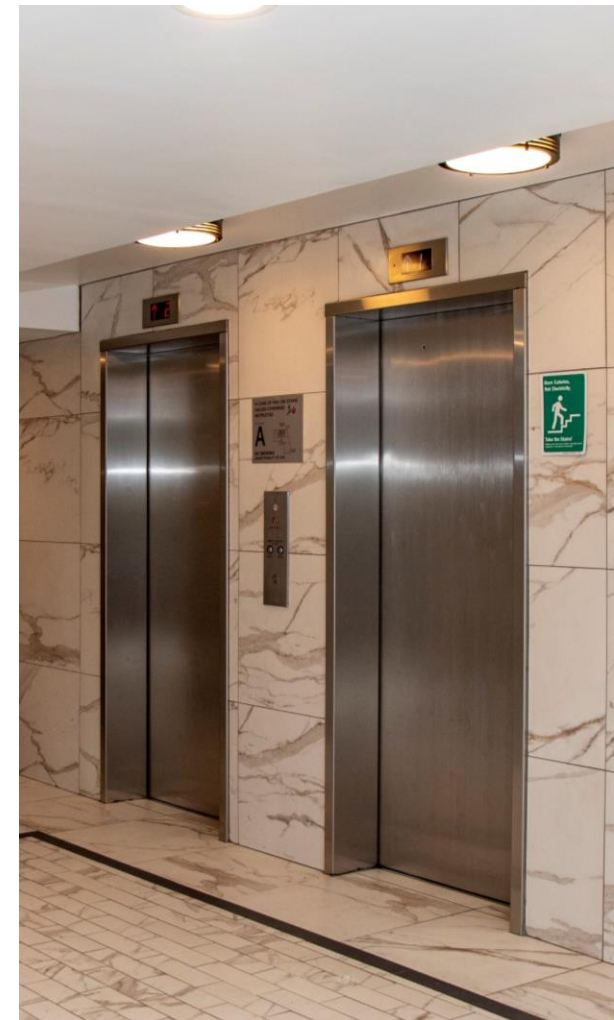
Ascensores modernizados, Independence
