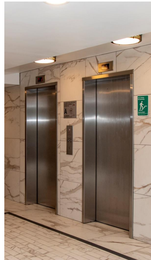
經翻新的電梯，Independence住宅區
