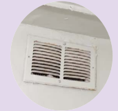
Ventiladores y conductos de ventilación por extracción de aire ($$)
